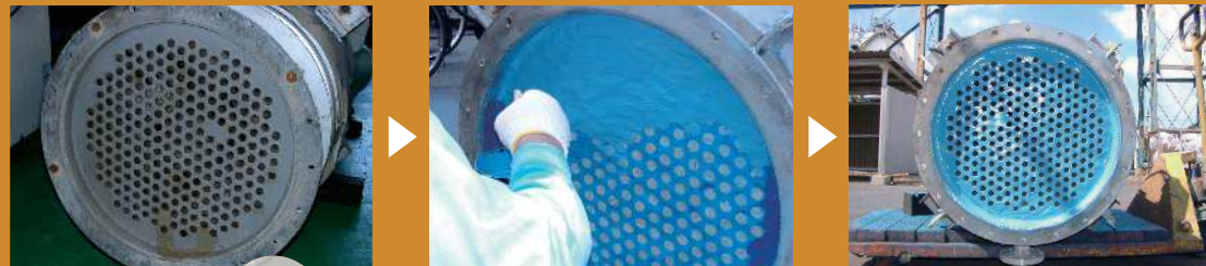
補修 ブラッシュャブルセラミックとセラミックリペアーを使用して、チューブ式熱交換器管板面の恒久的な補修ができる。
