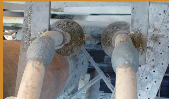
補修 廃プラスチックが当たり、穴が開いている配管のエルボー部を、ファインロード300で補修。
